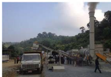
アスファルト合材プラント
