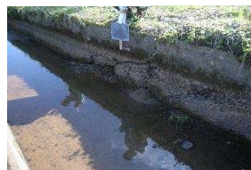
老朽化の著しい水路
